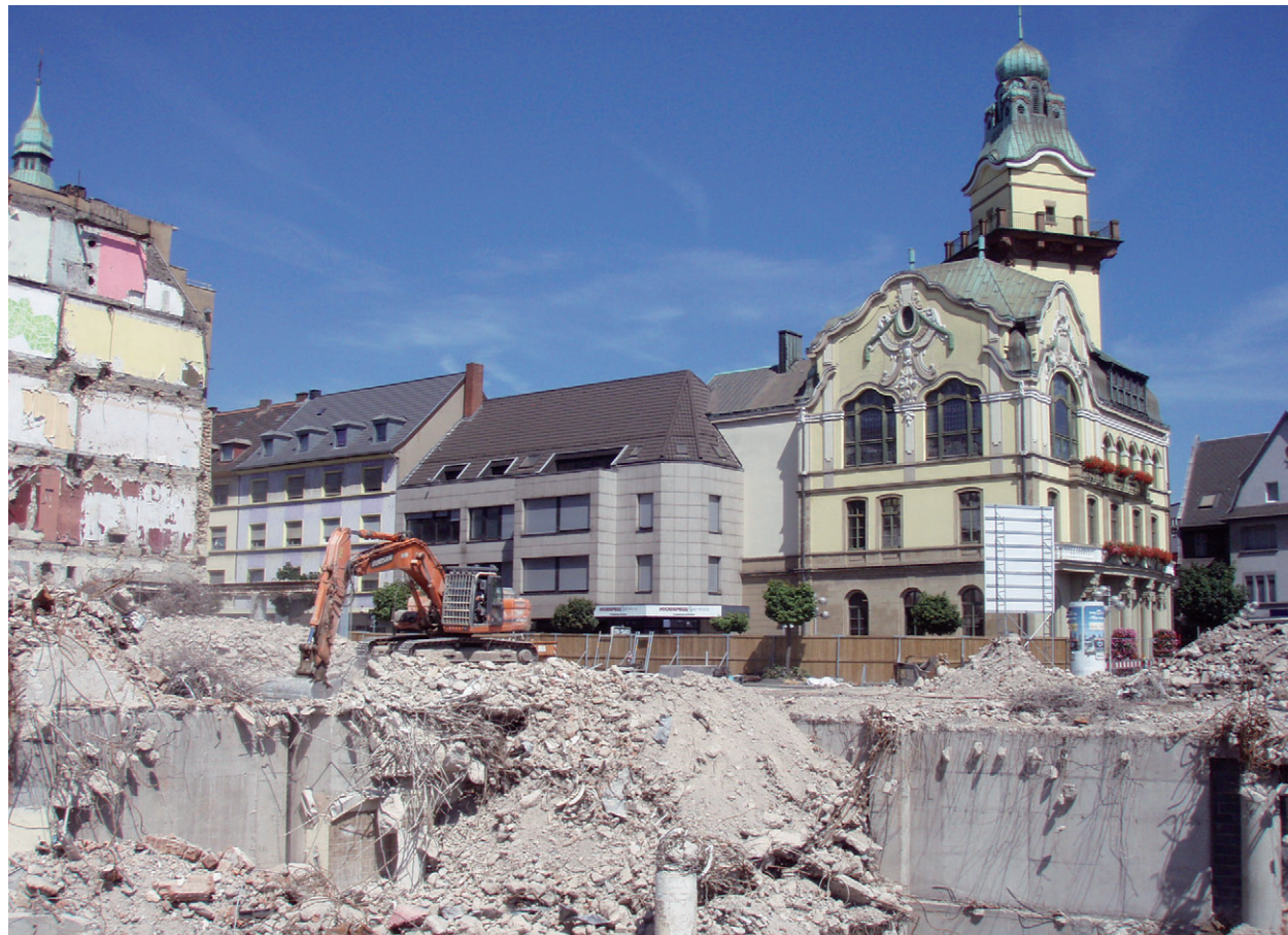
Die Abbrucharbeiten rund um das alte Kaufhof-Areal nähern sich nun dem Ende
